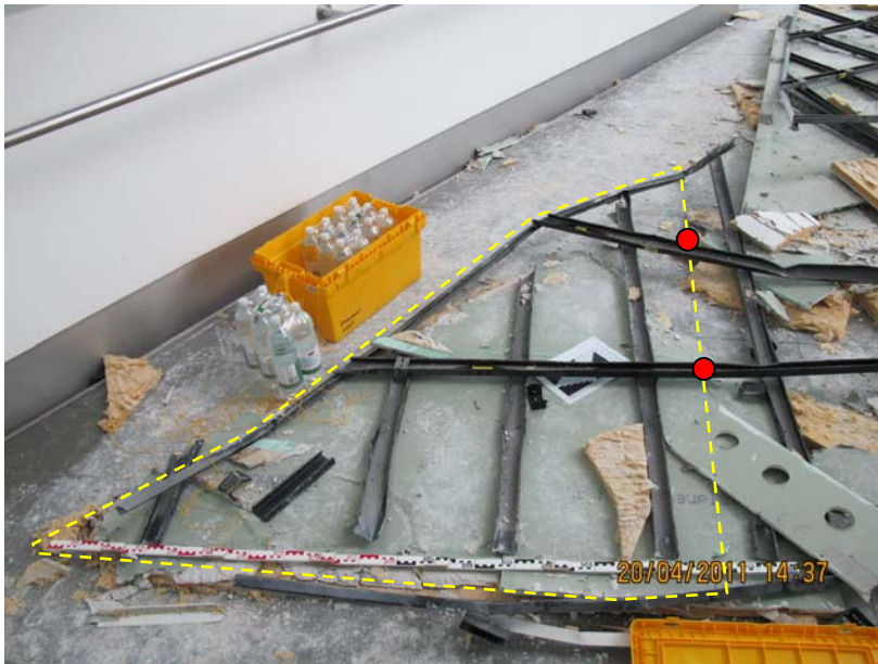
Bild: Rekonstruierte Decke am Hallenboden nach dem Absturz. Die auskragende Ecke ohne Abhänger ist offensichtlich (Strichlinie: frei auskragender Eckbereich, rote Punkte: ursprüngliche Position der dem Eckbereich angrenzenden ersten Hänger).
